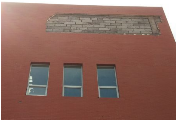
图 14 外保温层脱落
