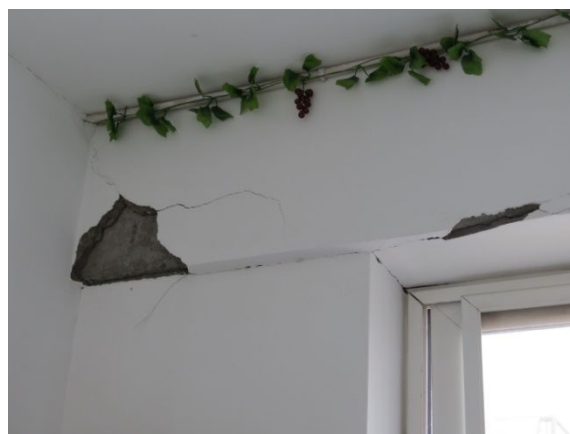
图 8 框架梁外面层裂缝
