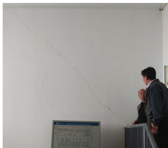
图12 墙体缺口处引起斜裂缝
