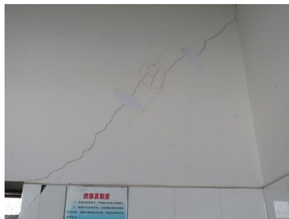
图11 填充墙层面层裂缝
