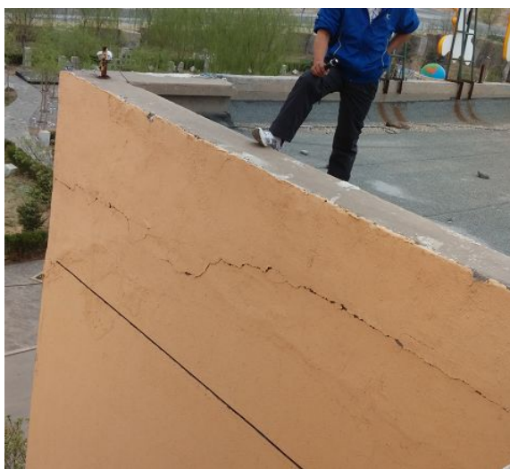
图 7 砌体女儿墙根部裂缝
