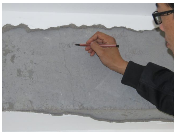
图 6 混凝土梁上竖向裂缝
