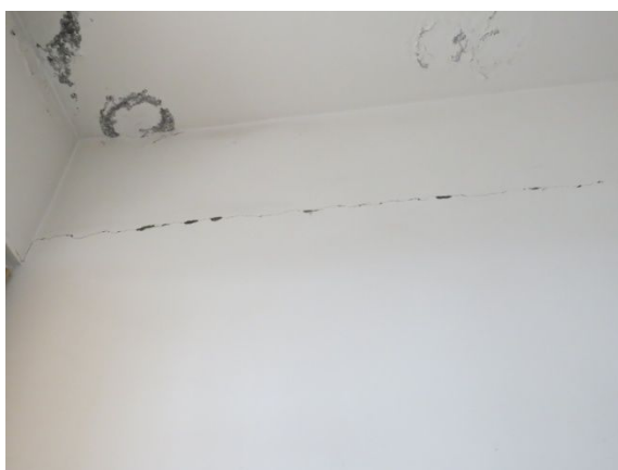
图10 填充墙与框架构件之间裂缝
