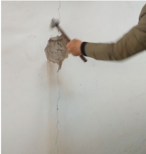
图 13 面层砂浆凿开后呈流沙状
