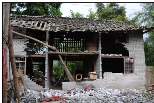
图10 全部采用120mm厚灰砂砖承重砌体房屋震害
