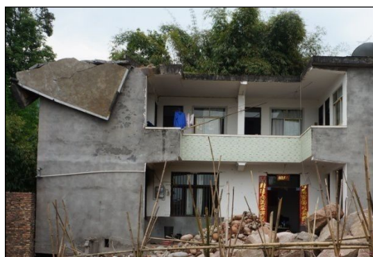
图 16 楼梯间出屋面层坍塌案例
