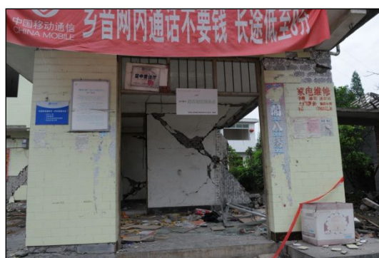
图9 现浇楼板房屋内外墙局部坍塌案例
