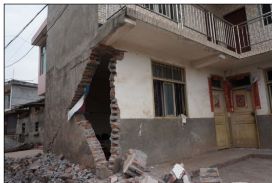
图8 现浇楼板房屋墙角坍塌案例
