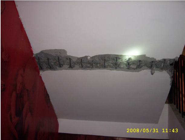
图2 板式楼梯梯板震害表现
