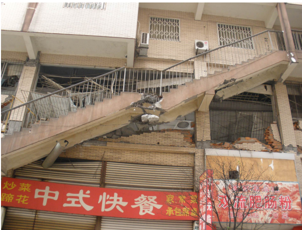
图3 梁式楼梯梯梁震害表现
