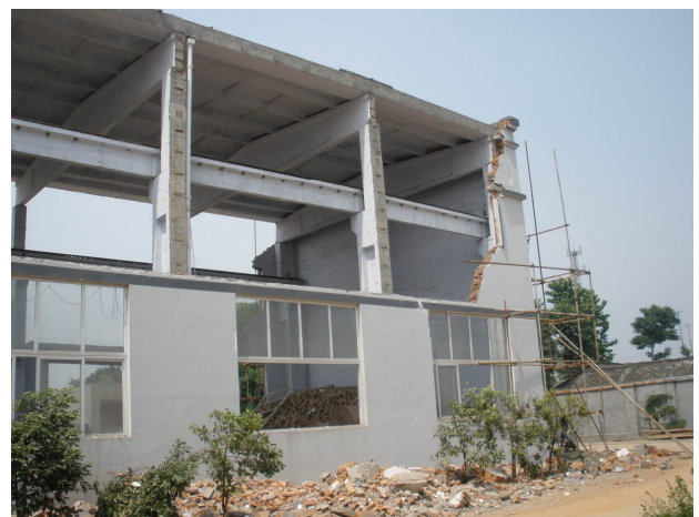
图 5 排架结构震害表现
