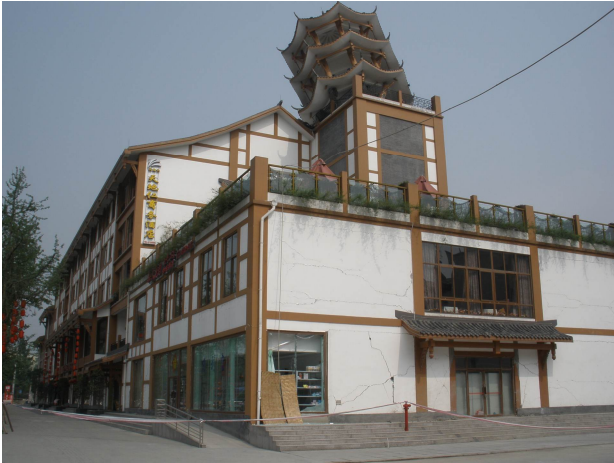
图1 都江堰某框架楼震害
