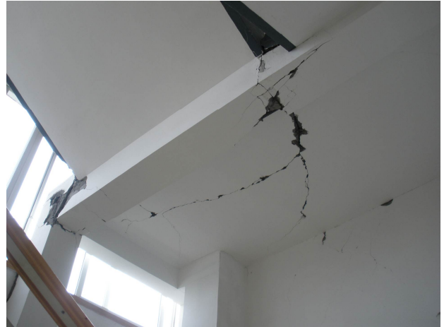
图4 层间休息平台板及梯梁震害表现
