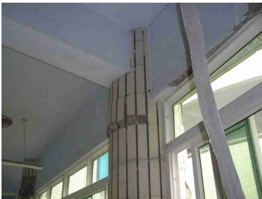
图 5.6 框架结构边柱出现剪切破坏
