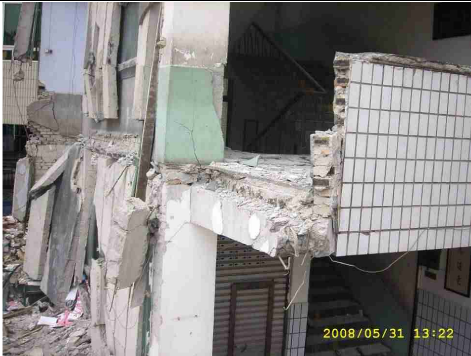
图 5.15 砌体结构未设置构造柱
