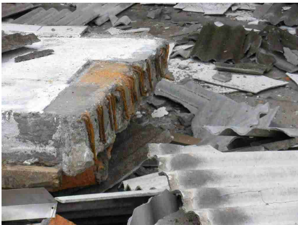
图 5.16 预制楼板主筋未进行锚固
