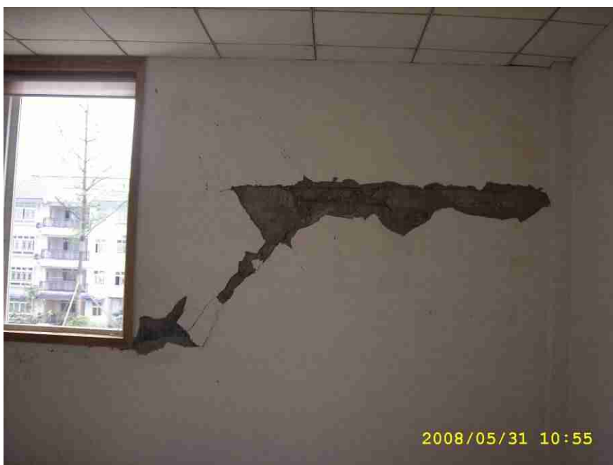
图 3.13 从建筑物内部看外部剪力墙出现的裂缝
