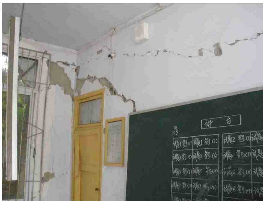
图 3.5 砌体结构横墙破坏情况
