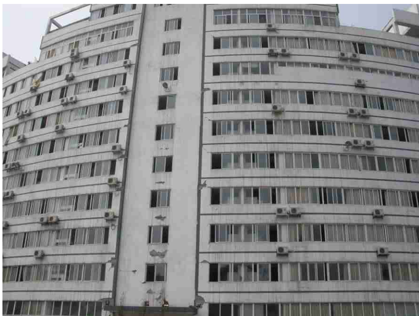
图 3.12 框架剪力墙震后外观，两道竖线间为剪力墙，下部有裂缝出现
