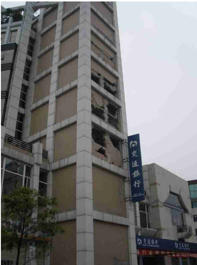
图 3.9 框架楼端墙建筑墙体裂缝及墙体脱落
