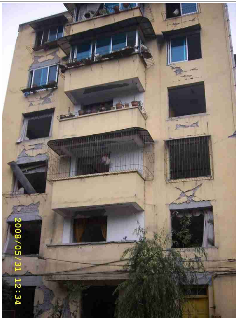
图 3.4 破坏较轻的砌体住宅，仅发生窗间墙 X 型剪切破坏
