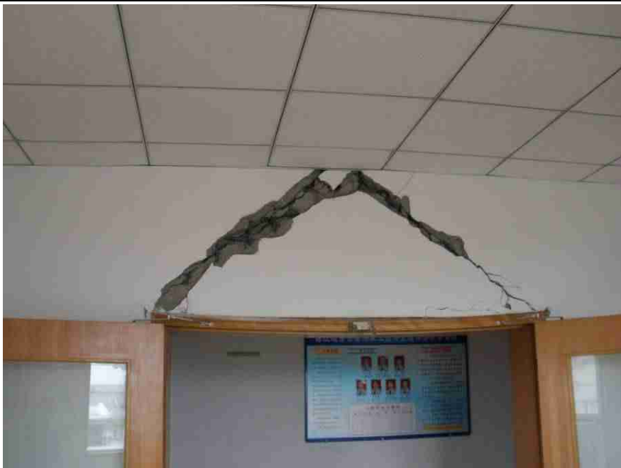
图 3.14 内侧剪力墙连梁出现剪切破坏，多数楼层出现类似状况
