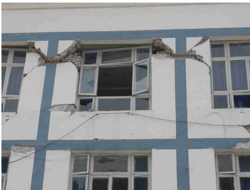
图 4.6 楼体受到严重损坏，可以看出震时的水平晃动相当剧烈，砌体成松散状
