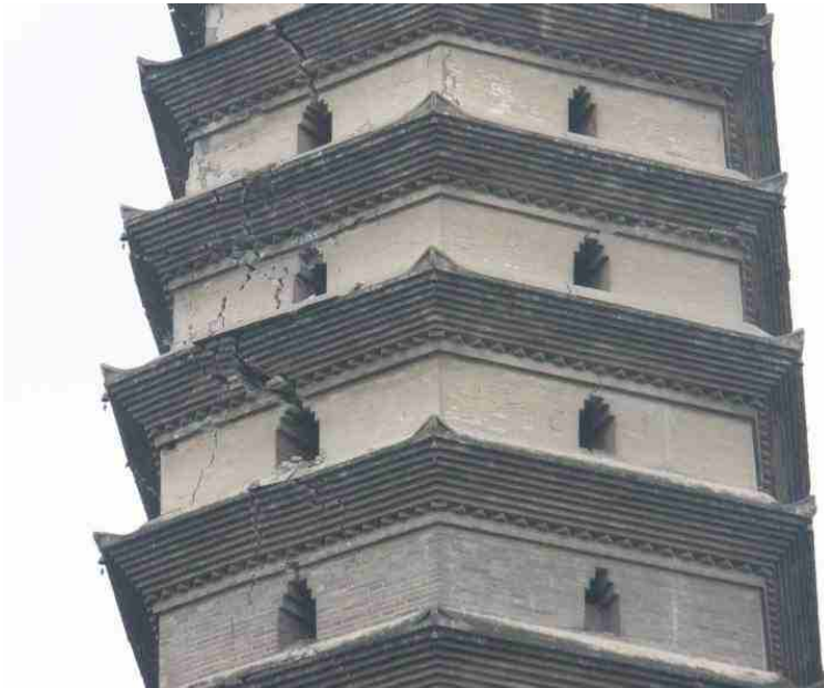
图 3.3 建于清道光年间、现存层数最多的古塔-奎光塔受损情况（高度 52.67 米，17 层）
