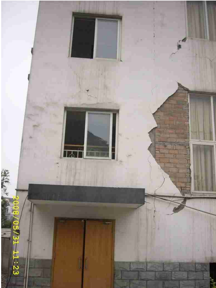
图 3.15 建筑物两端楼梯间剪力墙底层窗间出现裂缝，建筑墙体与剪力墙间也有裂缝
