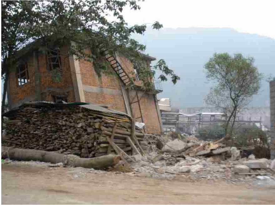
图 4.1 倾斜的砌体建筑，采用了构造柱圈梁抗震措施，旁边未采用该措施的房屋倒塌
