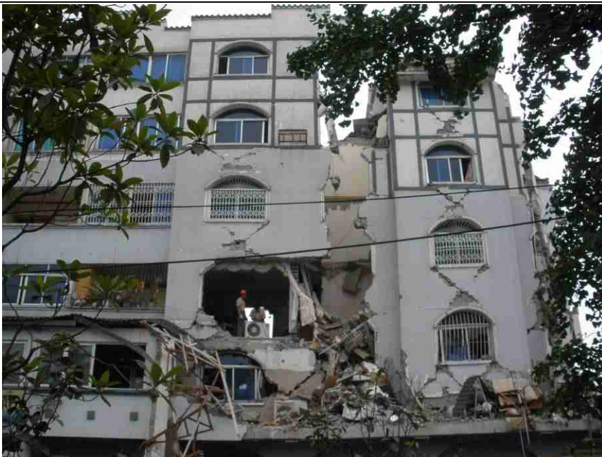
图 3.6 右侧楼梯二层整体压溃，致使临近开间预制楼板脱落破坏
