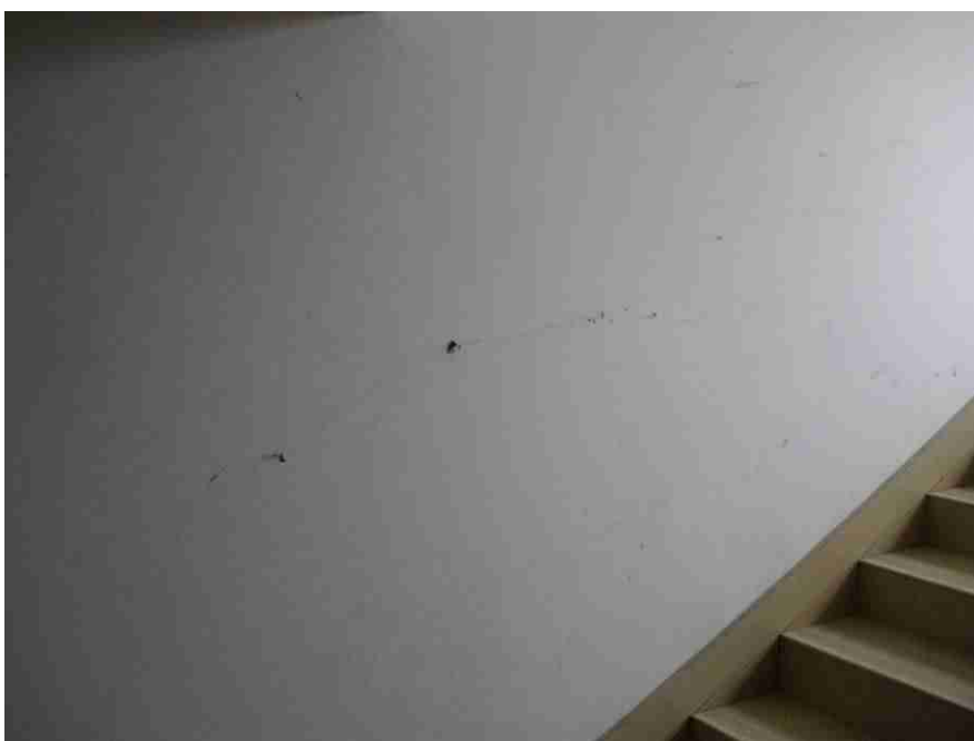
图 3.14 建筑物两侧楼梯间剪力墙出现斜线裂缝
