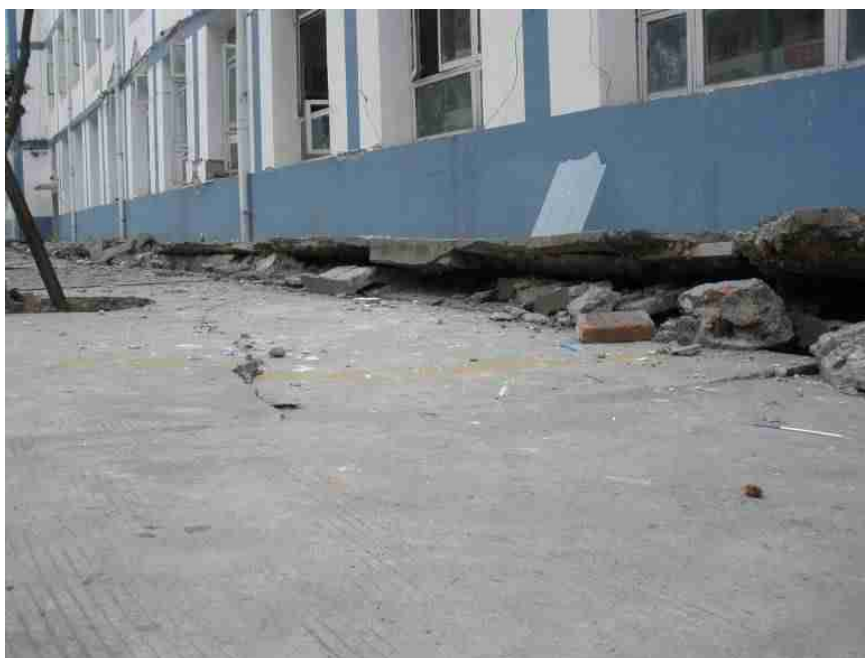
图 4.4 地形变化处东侧教学楼，楼体基座受到严重横向挤压发生错位
