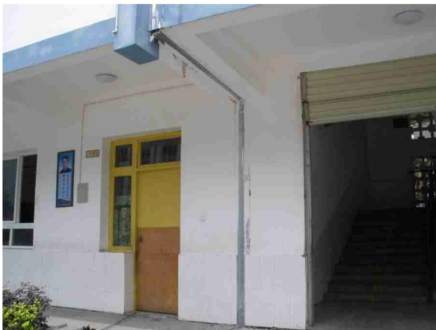
图 4.8 西侧教学楼仅在抗震缝两侧有碰撞痕迹及轻微变形裂缝，未发现受损痕迹
