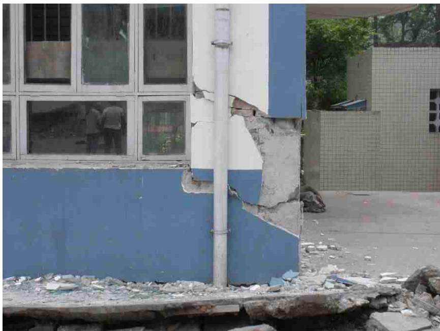
图 4.5 多数构造柱发生剪切破坏，砌体砂浆强度的直观感觉并不高
