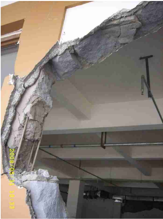
图 3.10 建筑填充墙破坏造成构造柱剪切破坏
