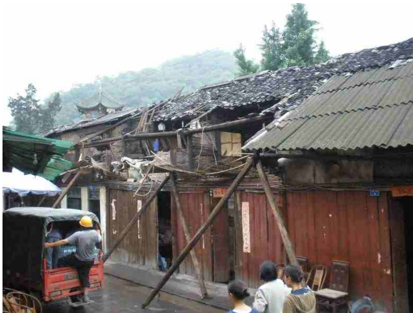
图 3.1 西街木结构建筑整体倾斜及屋面脱落情况。
