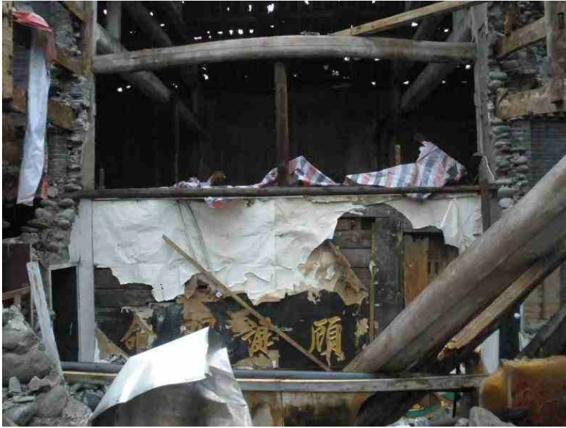
图 3.2 四川省文物保护单位采用石砌墙体、木屋架结构在地震中损毁
