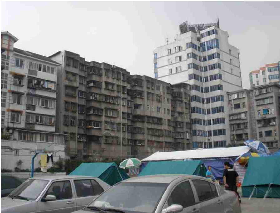
图 3.8 中间的居民楼倾斜倚靠在旁边框架楼（居民楼属底框结构）
