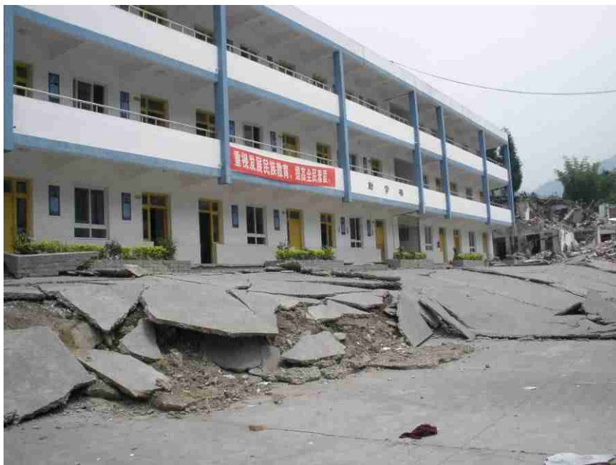
图 4.7 地形抬高处西侧的教学楼，结构保持完好，可能未受到水平地震作用影响
