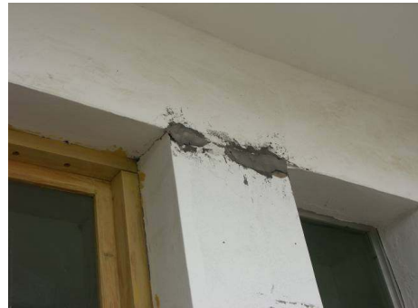
图 12 小墙肢水平裂缝
