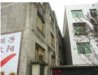
图 11 建筑物间没有 防震缝宽度
