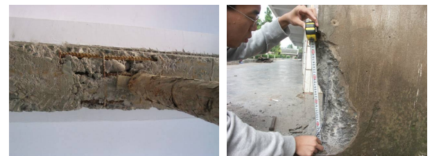
图 8 不符合质量要求的梁构件 图 9 抽查构造柱配筋情况
