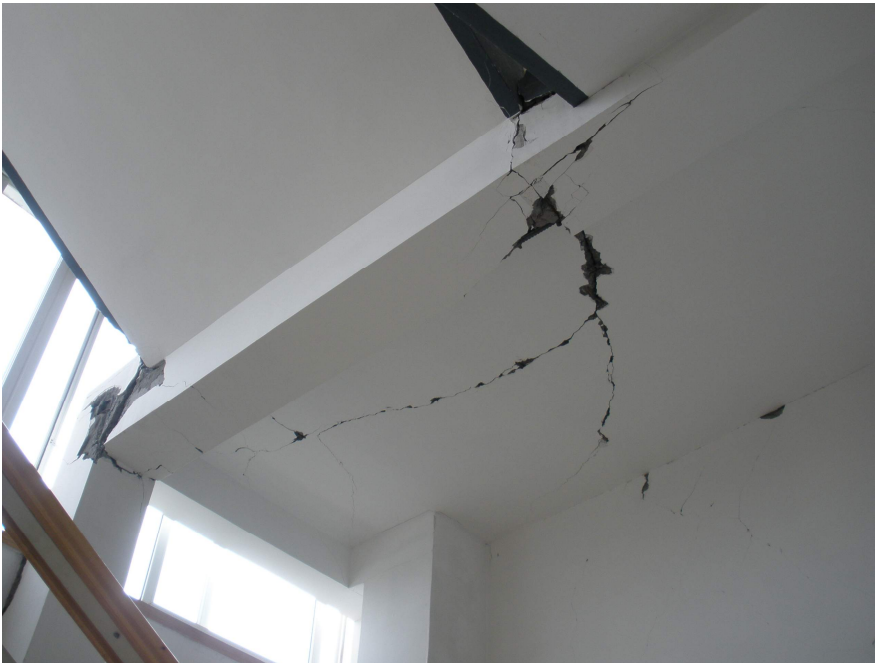
图 5.28 楼层中部休息平台被拉裂，梯梁在中部发生剪切破坏
