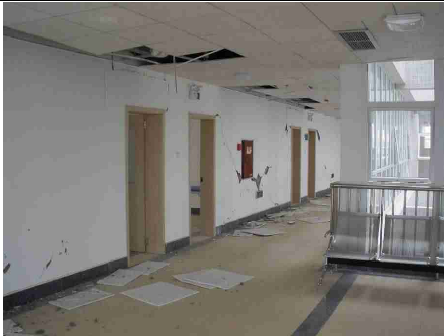
图 5.2 框剪结构中柱间纵向建筑墙体破坏表现
