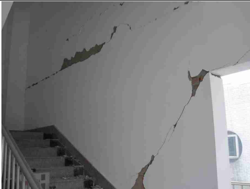
图 5.4 框剪结构中楼梯间处建筑墙体破坏表现
