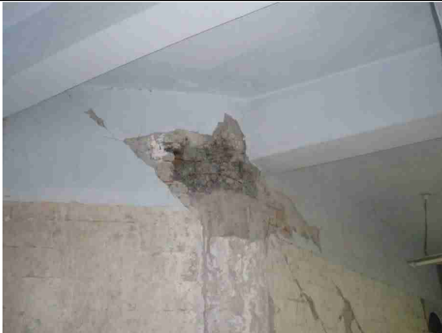
图 5.5 框架结构中柱体在一层梁下出现压屈破坏
