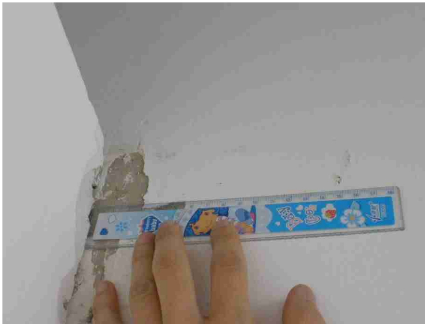
图 5.1 八层框剪结构建筑中，第五层房间内小隔墙顶部（距地面 2.0 米）在地震中晃动留下的痕迹，摆动幅度接近 200mm
