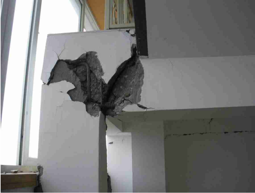
图 5.27 梯柱与梯梁相交节点发生破坏，箍筋间距不能满足抗震构件要求
