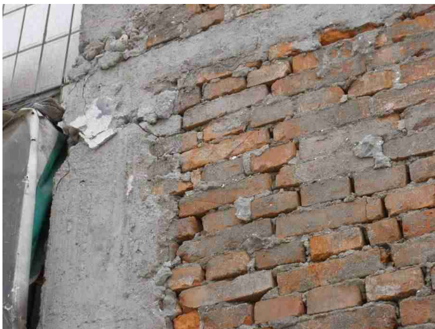
图 5.12 砂浆砌筑不饱满，墙体在地震中未起到足够抗剪作用，全部依靠构造柱能力
