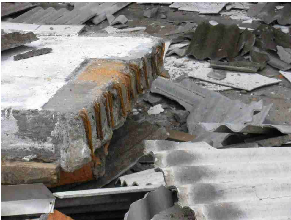
图 5.16 预制楼板主筋未进行锚固
