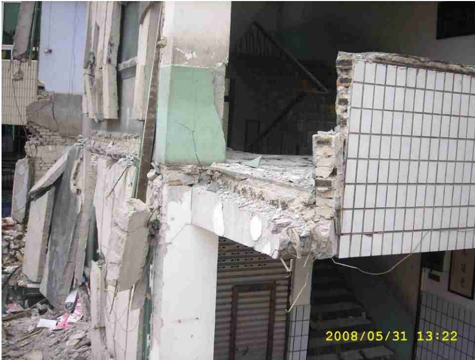
图 5.15 砌体结构未设置构造柱
