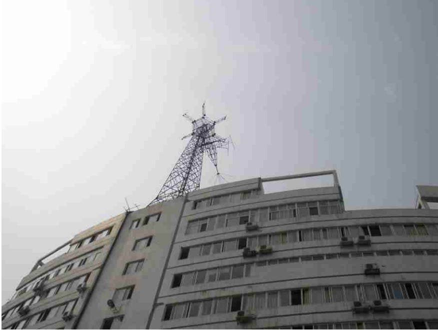
图 5.23 十四层框架剪力墙楼上设无线发射钢塔架，地震中整体弯折
