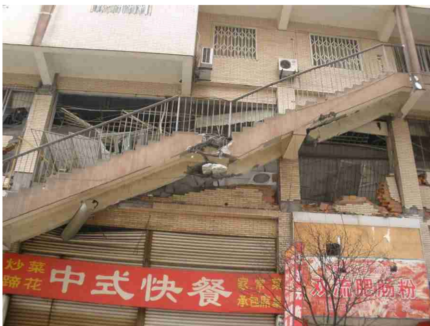
图 5.26 框架楼外部悬挑梁式楼梯，楼板及梯梁均破坏
