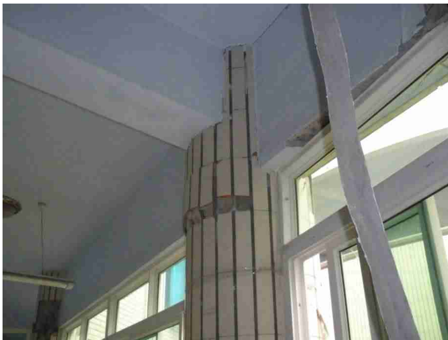
图 5.6 框架结构边柱出现剪切破坏
