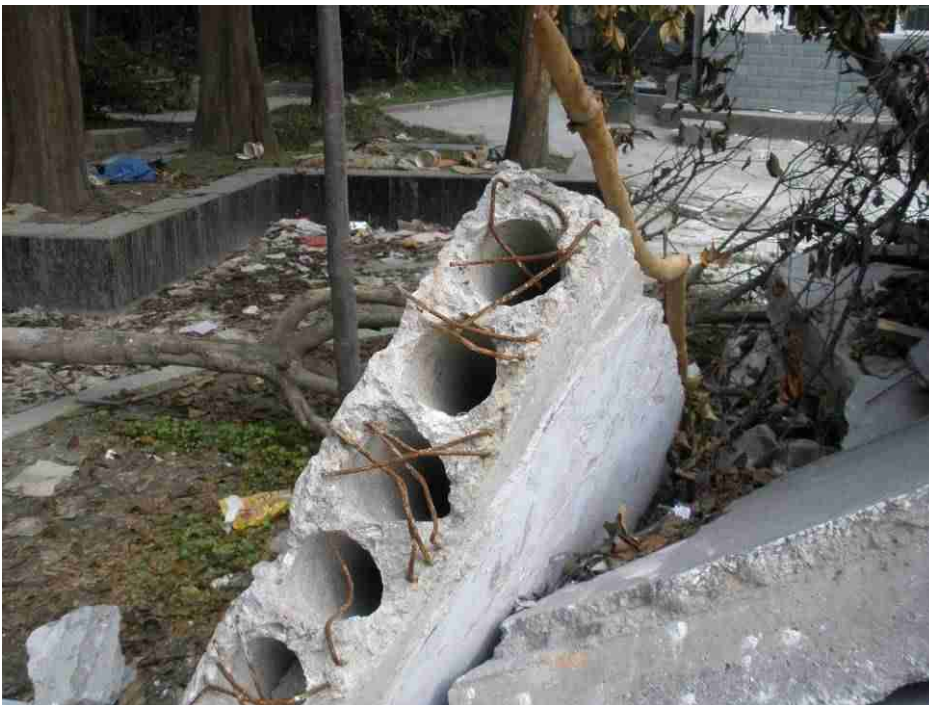
图 5.14 折断的预制楼板，板中的主要受力钢筋为非预应力钢筋
