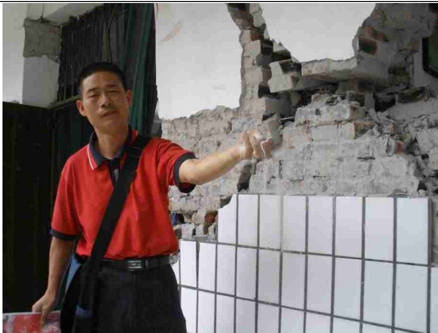
图 5.9 砌块间砂浆强度不足，已成粉末状，丧失抗剪能力
