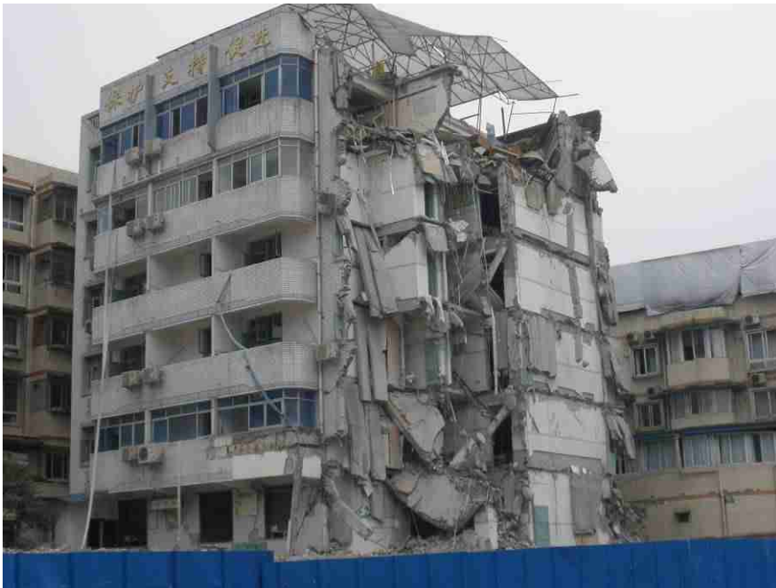
图 5.8 采用预制楼板的砌体结构，右侧部分在地震中倒塌，墙上挂着预制板
