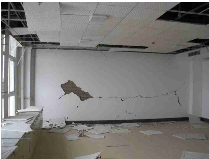
图 5.3 框剪结构中柱间横向建筑墙体破坏表现
