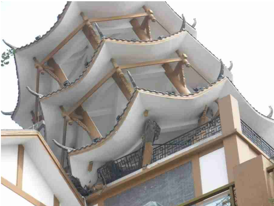
图 5.22 三层框架楼上设三层造型建筑，地震中框架柱全部剪断
