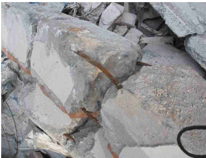
图 5.10 圈梁箍筋间距超过 200mm，圈梁失去抗震作用
