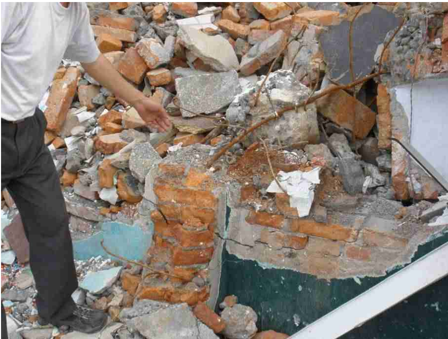
图 5.18 教学楼设置了构造柱, 地震中楼体底部有整体剪切破坏迹象, 构造柱上也设置墙体拉结筋, 拉结长度大约为 700mm;
