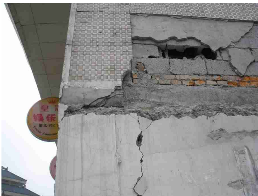
图 5.4 框剪结构中端墙建筑墙体破坏，框架梁出现竖向裂缝，框架角柱出现横裂缝
