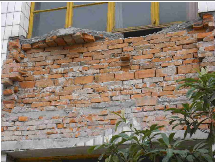
图 5.11 很多砌体墙不按要求砌筑，该窗间墙由两层墙体组成，缺少连接，地震中外侧墙皮被震落
